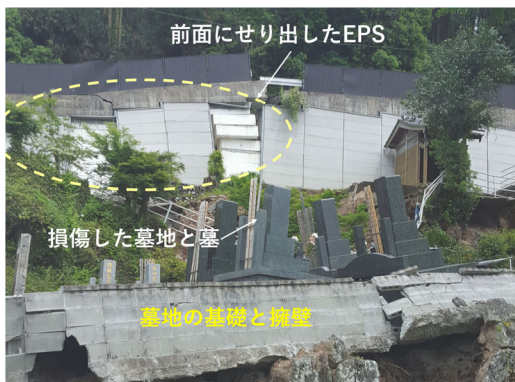
(a) EPS 盛土と基礎地盤の損傷の様子
